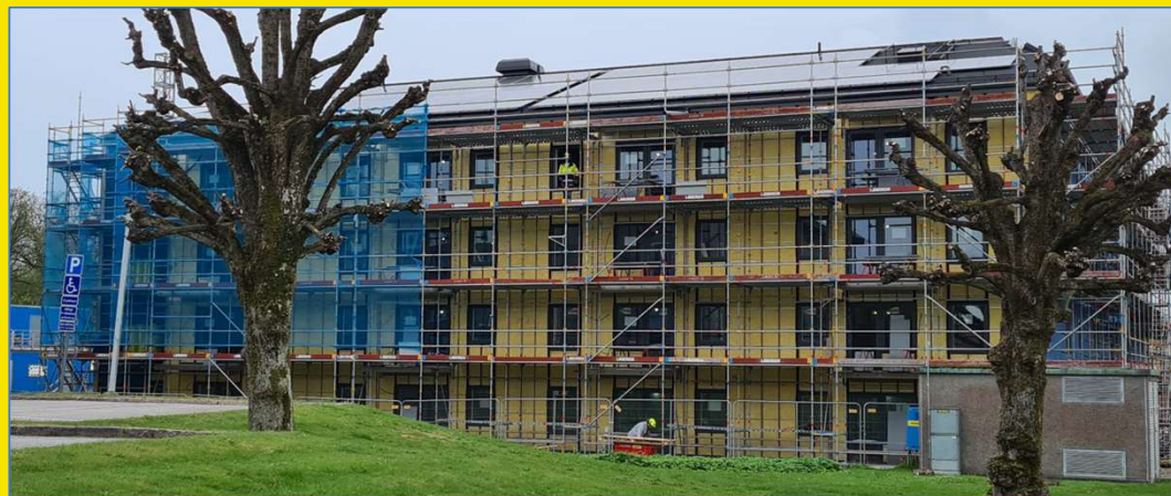
Uddevallahems nya hus på Strömstadsvägen, ett föredöme med taket täckt av solceller.
